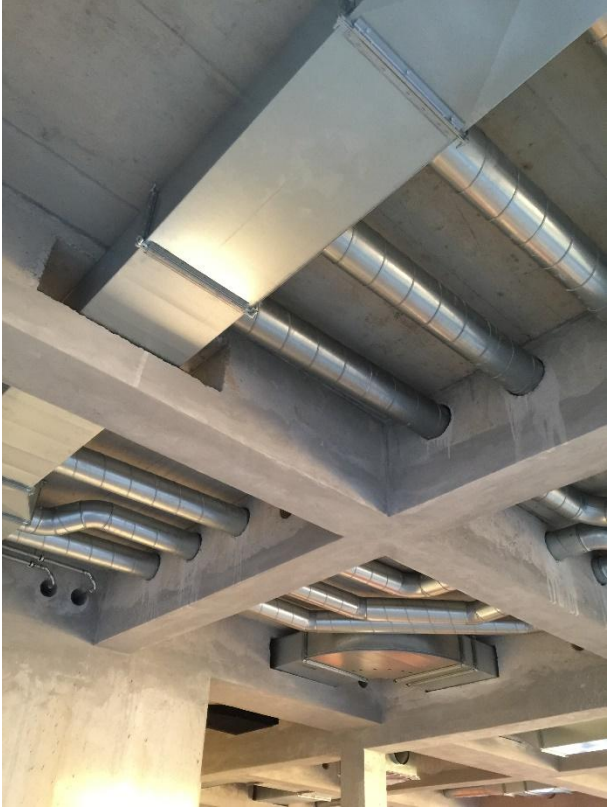
Durch Statik „verzweigte“ Lüftung
