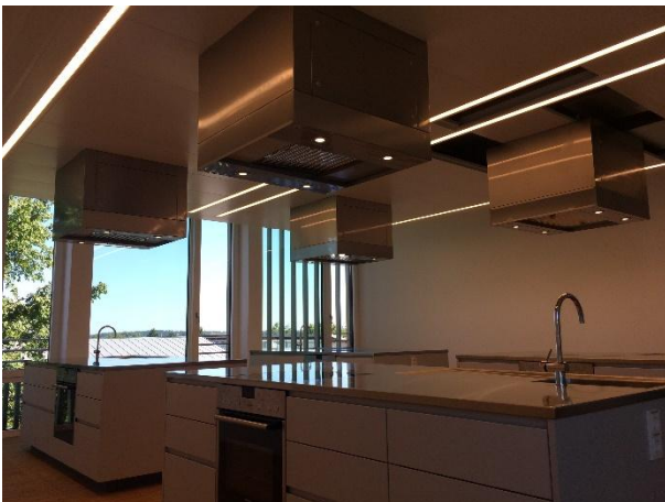
Lehrküche mit Dunstabzugshauben
